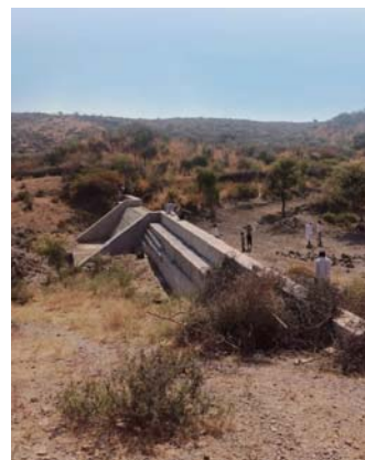
砂防ダムの高さは4.3メートル、基盤の深さは2.1メートル、集水域は幅3〜7キロです
